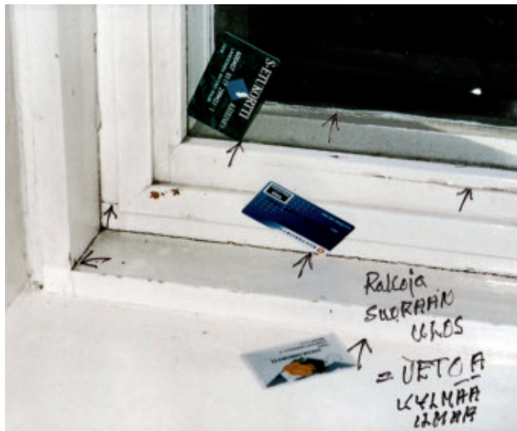
TÄSSÄ korttipelissä ei kannata huijata. Muovikortilla on helppo testata ikkunoiden liitoskohtien tiiviys. Myös uudet ikkunat kannattaa testata.
