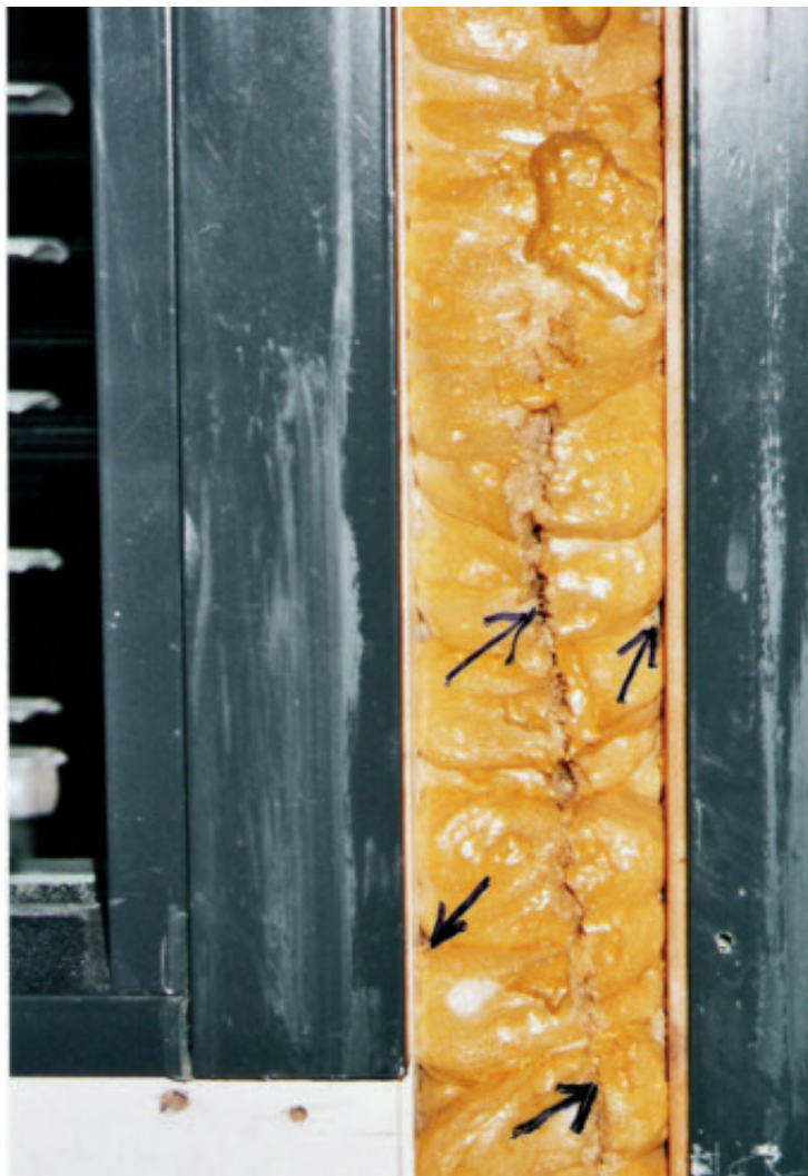
KOKO valoaukon lämpöeristetyöt on syytä tarkistaa ennen vuorilautojen kiinnitystä. Tässä seinän ja karmin väliin ruiskutettu uretaani on haljennut ja siihen on jäänyt ulos asti ulottuvia tyhjiä kohtia.
